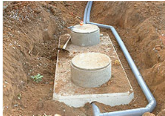
Fosse toutes eaux enterrée
