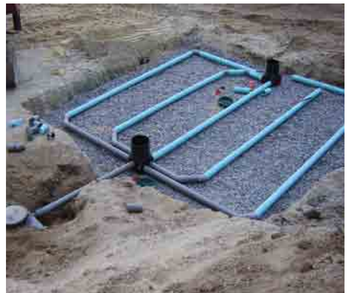
filtre à sable vertical non drainé
